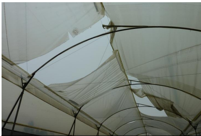
Das stark beschädigte Gewächshaus
